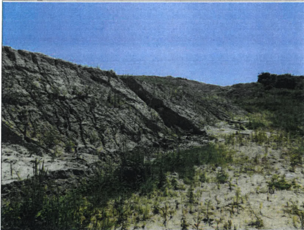
Osunięcia w obrębie skarpy nasypu spowodowane przepływem wód powierzchniowych.
