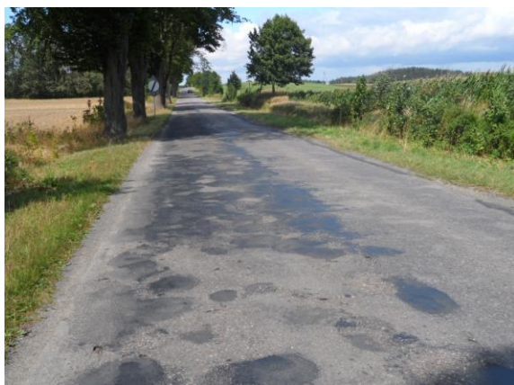
Zdjęcie 11.2.1 Droga powiatowa Nr 1335N – fragment nawierzchni w stanie technicznym złym
