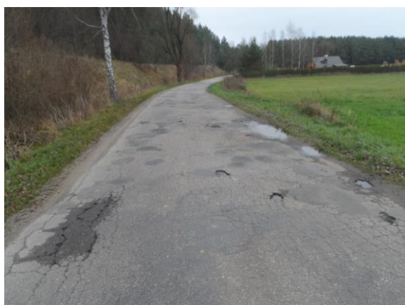
Zdjęcie 11.2.1 Droga powiatowa Nr 1319N – fragment nawierzchni w stanie technicznym złym
