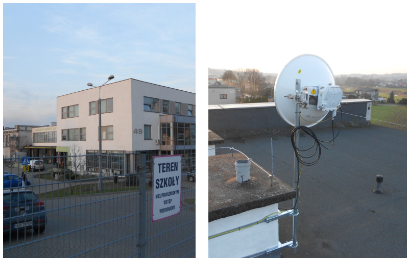
Widok obiektu wraz z zainstalowanym zespołem antenowym
